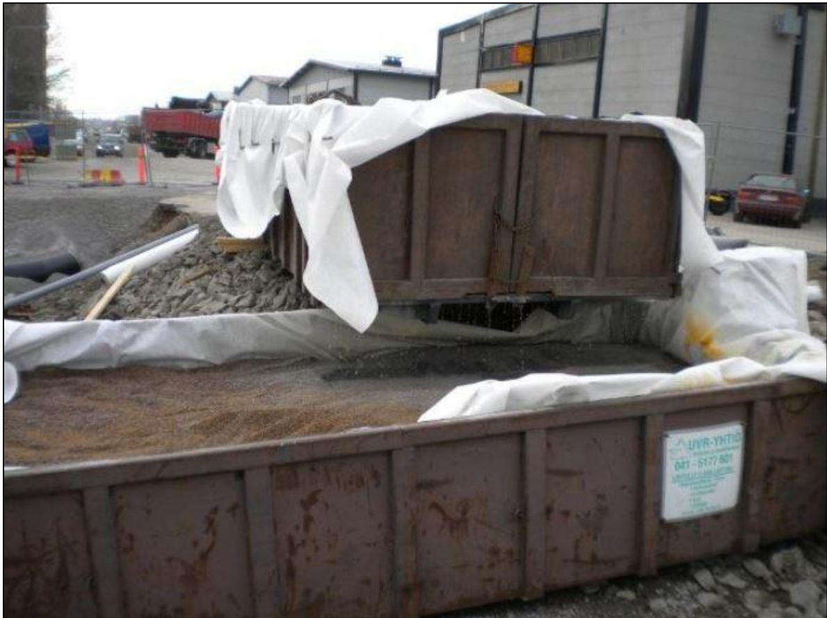
Kuva 6. Esimerkkikuva vaihtolavan sisään rakennetusta suodattimesta. 7
